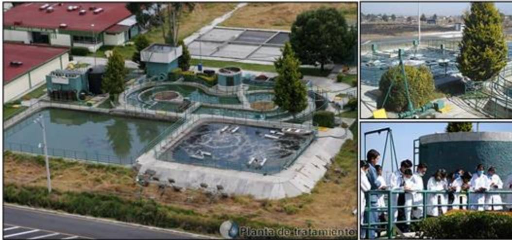
Figura 11. Instalaciones de la Planta Piloto de Tratamiento de Aguas Residuales.
